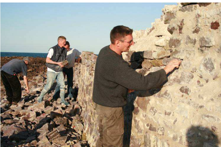
La réparation de la digue consiste pour les parties écroulées à remonter et à maçonner à la chaux le mur de parement vertical extérieur sur une hauteur d'une coudée (environ 60 cm), pour faire une ligne horizontale, puis à remplir par le haut et « à refus » la cavité ainsi créée, avec un mortier très liquide moitié chaux, moitié sable de mer, mélangé de pierres en vrac. Et ce autant de fois que nécessaire pour atteindre le niveau du parement horizontal du haut de la digue
